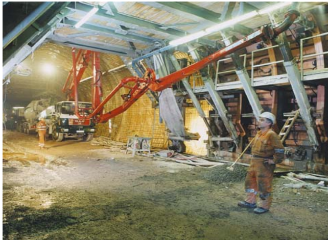
شکل ۴-۱۰-۷- پمپ بتن تونل
